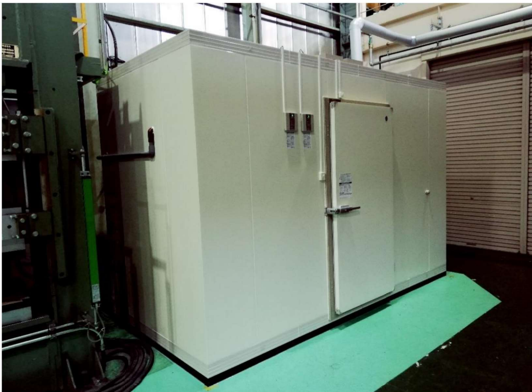
第二工場プリプレグ保管用冷凍庫
