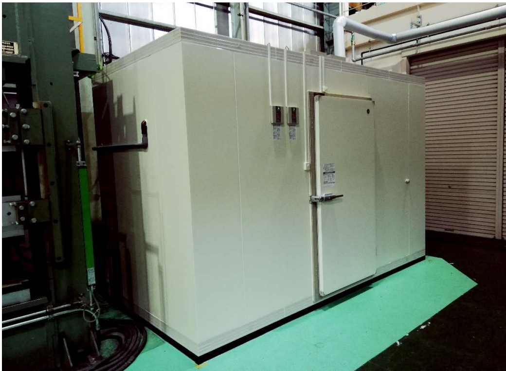
第二工場プリプレグ保管用冷凍庫
